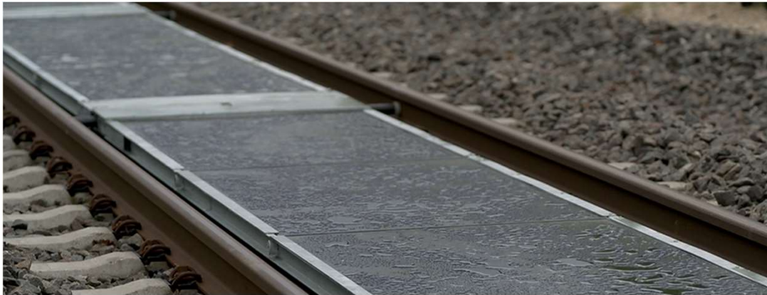
Solarpaneele im Eisenbahngleis
